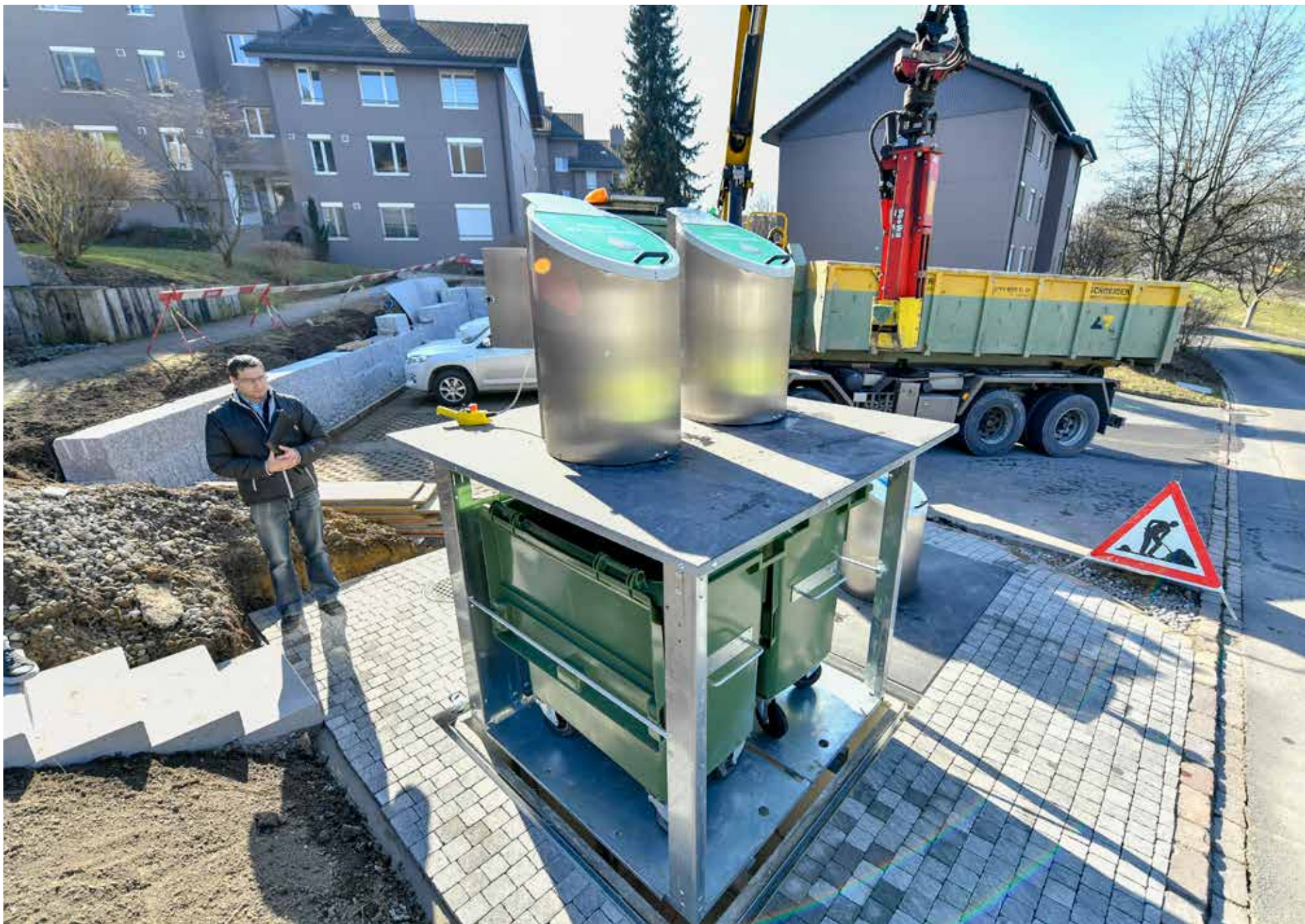
Grüngut-UFC an der Untermühlestrasse in Cham: Die Grüngut-Container lagern auf einem Lift im Untergrund.
