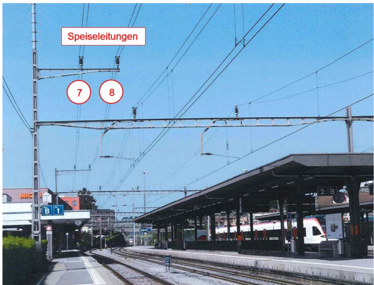
Abbildung 5: Verlauf der südlichen Speiseleitungen im Perronbereich
